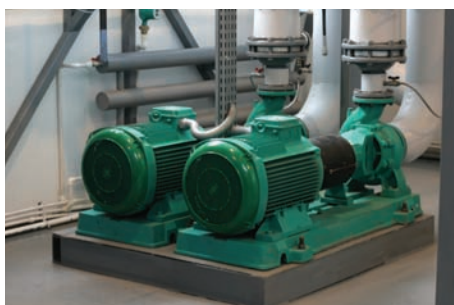
HLK-Systeme, Pumpen und Ventile
